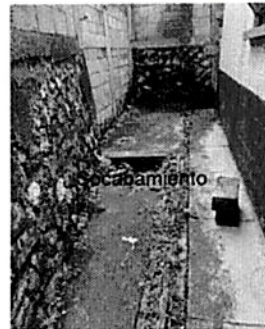
Foto 4: SOCAVAMIENTO EN MURO PERIMETRAL de 5 x 1 ml
