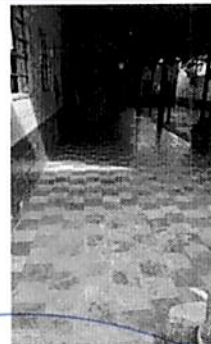
Foto 6: INSTALACIÓN DE PISO CERAMICO EN CORREDOR DE 24.13 X 3.10 M PISO SOBRE PISO
